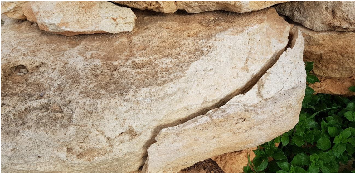
Fractura de la pedra.
