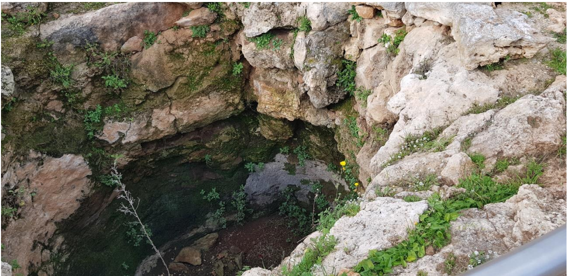
Element on s'acumula aigua. Requereix un estudi per valorar la incidència de l'acumulació d'aigua i la viabilitat o necessitat de sistemes de drenatge.
